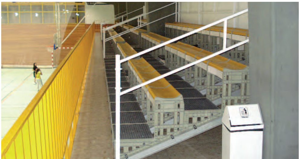
Barandillas de protección.
