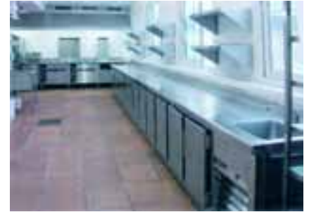
Figura 97 – Dos aspectos muy importantes en las cocinas son el mantenimiento del orden y evitar los obstáculos en las zonas de circulación.
