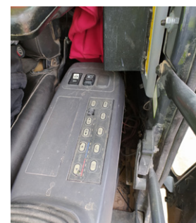
Figura 45. Sistema de climatización en minixcavadora. Fuente: Estudio de campo.
